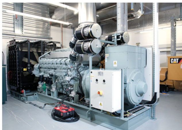
Mezi špičkové technologie v datovém centru GreenDatacenter Zurich West patří i tento diesellový generátor.
