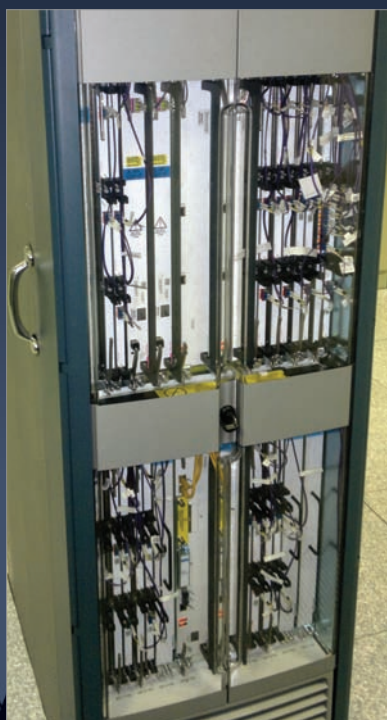
Připojení do internetu: Takovými routery se Telefónica připojuje do páteří sítě. Odběr elektriny může dosáhnout až 13 kW.
