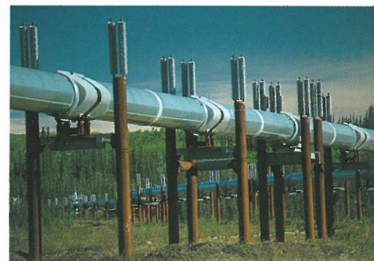
Alaska Pipeline, vedení dlouhé 1 288 kilometrů, bývá hodnoceno jako jeden z nejmělejších inženýrských projektů 20. století.
